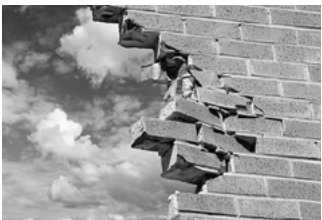
Mur trencat / Muro roto
